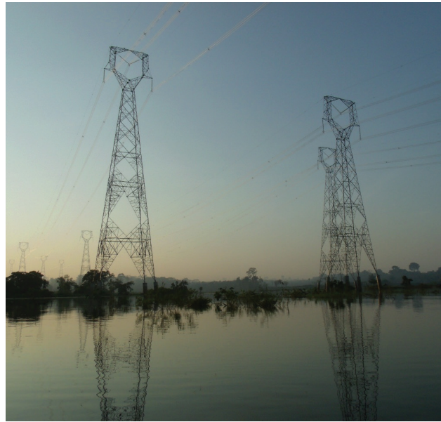
Figura 13 – Linha de transmissão da UHE Santo Antônio, rio Jaciparaná/RO (Foto: Aderson Alcântara).
